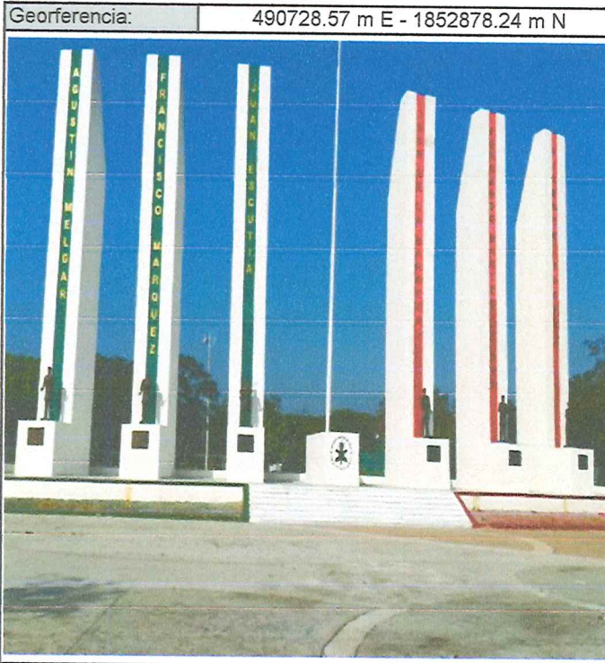
Descripción: PINUTRA EN MAL ESTADO
